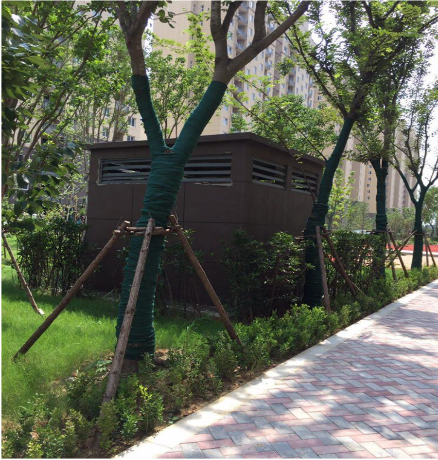
图片 3 地下车库排风口
